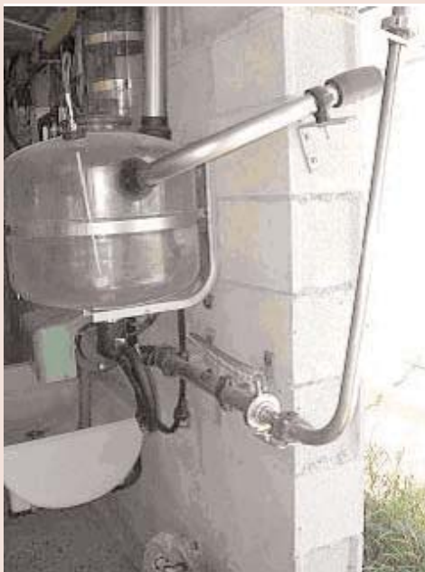
Transfert par la pompe de reprise
