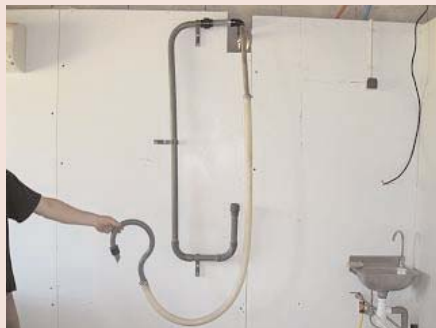
Tuyau souple en fromagerie à relier vers les bacs de caillage
