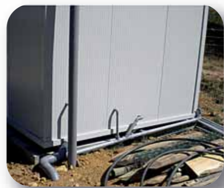
Raccordement des siphons de sol de la fromagerie modulaire au système de traitement des eaux usées, ici une fosse septique + épandage souterrain
