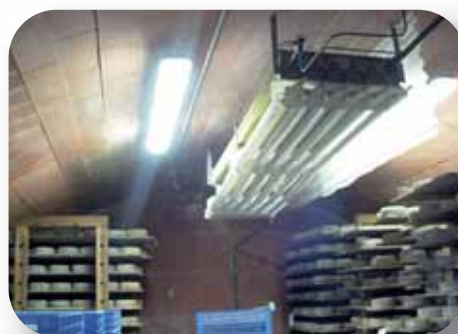
Cave d'affinage avec une installation frigorifique à évaporateur statique
