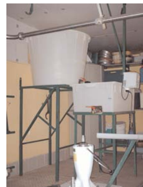
Double cuve tampon
