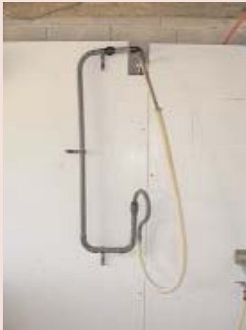
Tuyau souple en fromagerie relié au circuit de nettoyage
