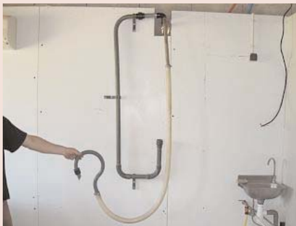
Tuyau souple en fromagerie à relier vers les bacs de caillage
